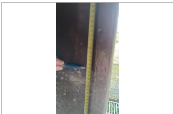
Laisse de crue à 65.5 cm/sol
