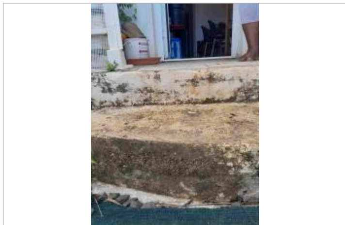
Dépôt de matières solides
