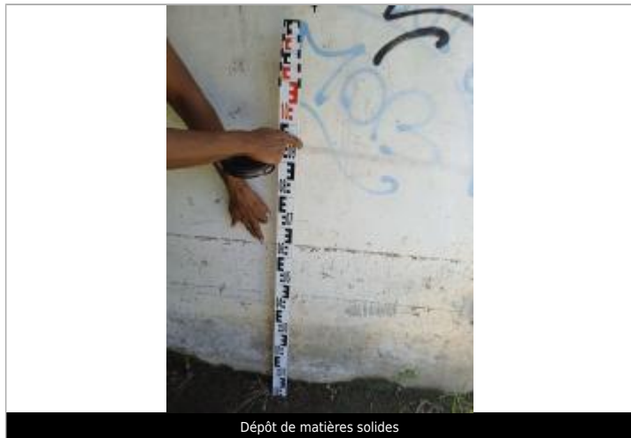
Dépôt de matières solides
