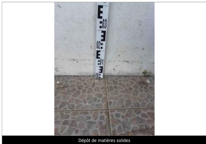
Dépôt de matières solides
