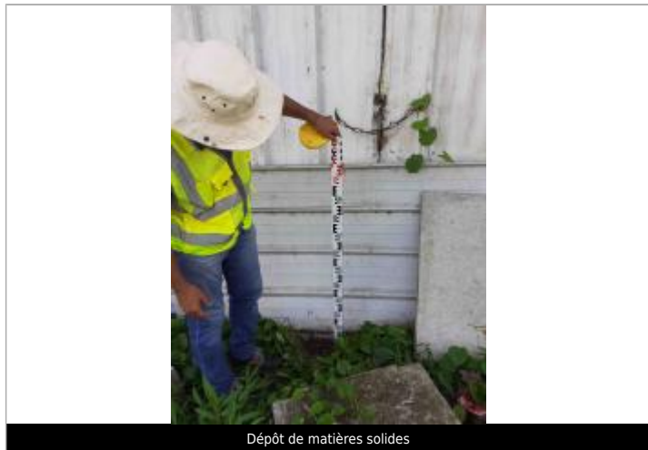
Dépôt de matières solides
