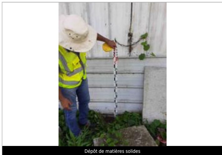
Dépôt de matières solides
