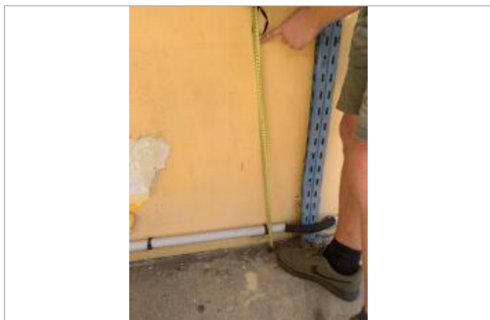
Témoignage d'une hauteur d'eau
