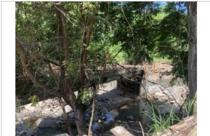
Ouvrage de franchissement partiellement détruit
