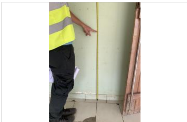
Témoignage d'une hauteur d'eau
