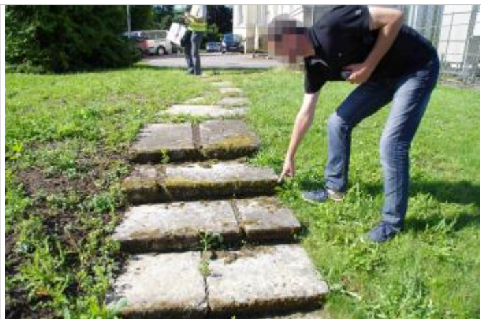
Vue rapprochée par la laisse de crue entre la 4ème et la 5ème marche en partant du bas. (Source : DDT 61).
