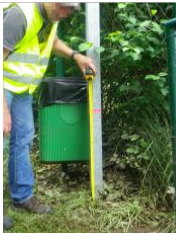
Vue rapprochée du coup de bombe de peinture sur fût panneau (Source : DDT 61).
