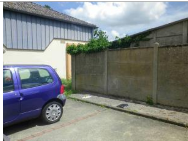
Vue d'ensemble de la laisse de crue sur mur en béton
