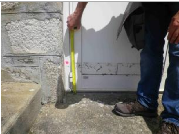
Vue rapprochée n°1 de la laisse de crue (Source : DDT 61).
