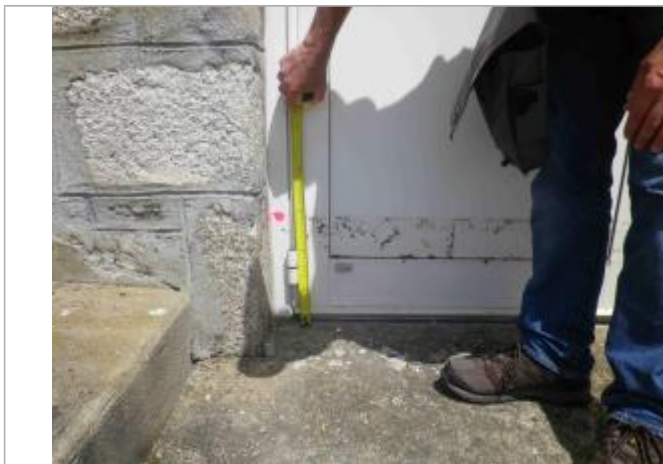
Vue rapprochée n°1 de la laisse de crue (Source : DDT 61).
