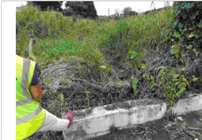
Dépôt de matières solides
