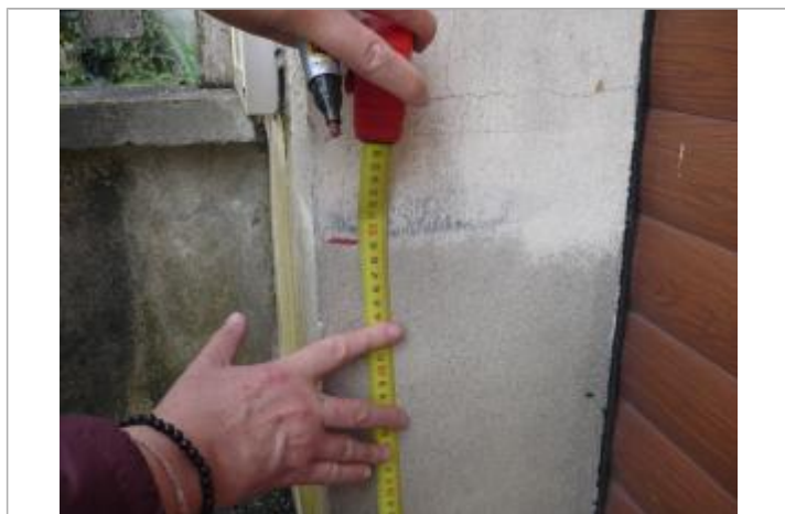
Vue rapprochée de la laisse de crue (Source : DDT 61)
