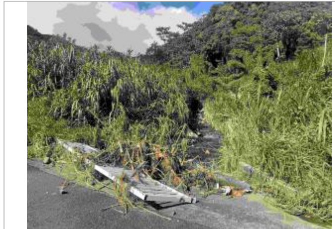
Ouvrages de protection cassés à l'amont du pont
