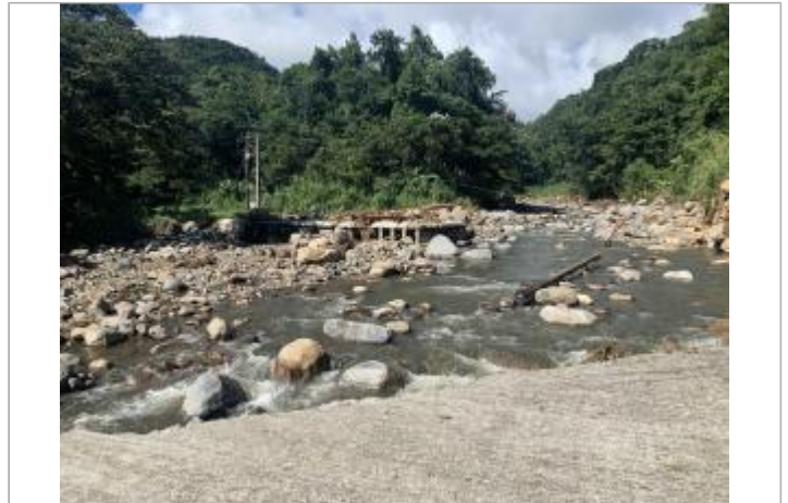
Ouvrage de franchissement détruit
