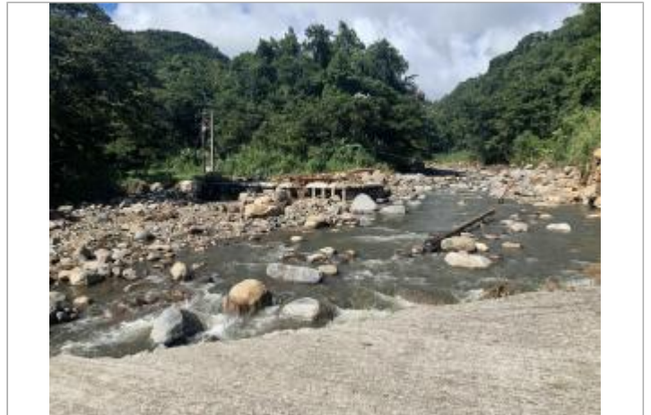
Ouvrage de franchissement détruit
