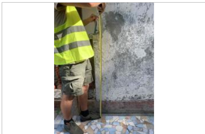
Dépôt de matières solides
