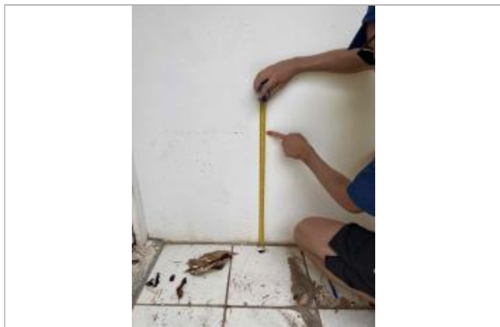
Dépôt de matières solides
