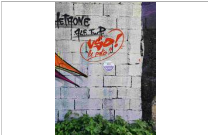
zoom sur le repère de crue posé
