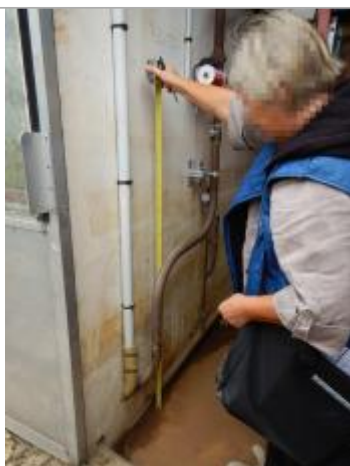
Marque de peinture sur le tuyau de la cuve à fuel (Source : DDT 61).
