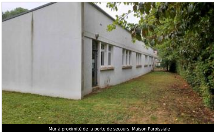
Mur à proximité de la porte de secours, Maison Paroissiale
