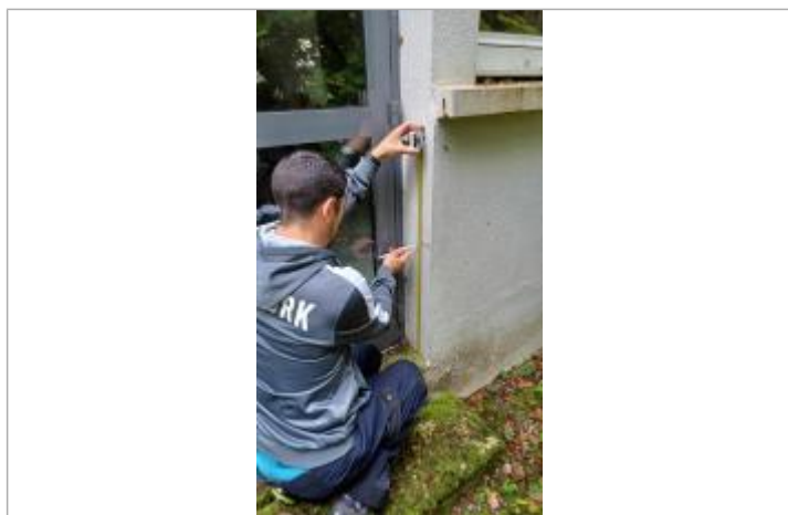
Laisse de crue inscrite sur le mur au marqueur à 52 cm/sol.
