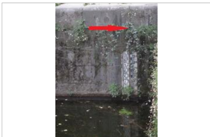
Ecluse du Mail à Rennes - échelle amont
