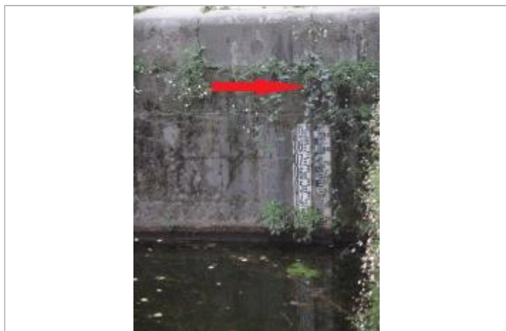
Ecluse du Mail à Rennes - échelle amont
