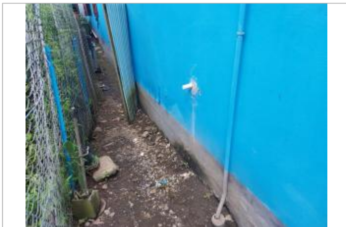
Laisse d'inondation sur mur d'habitation
