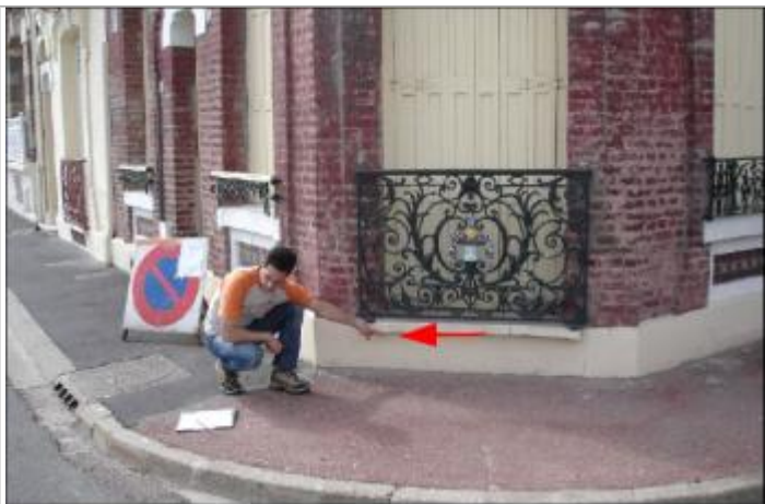
Laisse de mer en dessous du rebord du balcon.
