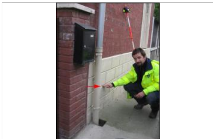
Laisse de mer au niveau du haut de la deuxième rangée de carrelage.
