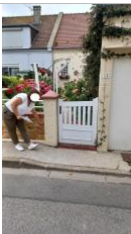
Laisse de crue au niveau du haut de la deuxième pierre en partant du bas (en excluant le petit découpage de pierre tout en bas) sur le pilier du portail.
