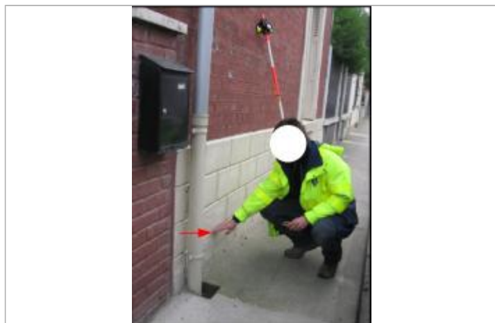
Laisse de crue sur la façade, en haut de la rangée de carrelage.
