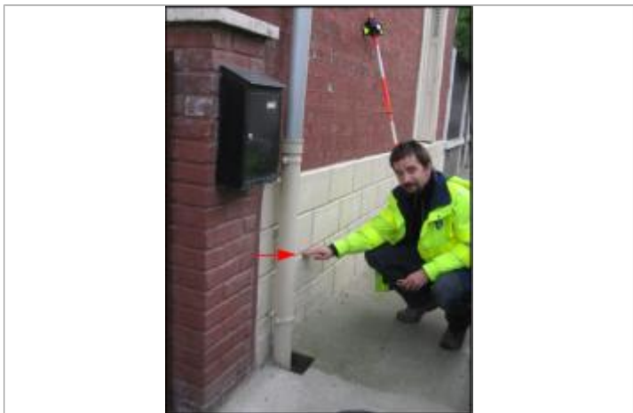
Laisse de mer au niveau du haut de la deuxième rangée de carrelage.
