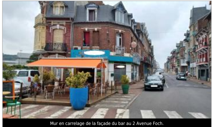
Mur en carrelage de la façade du bar au 2 Avenue Foch.
