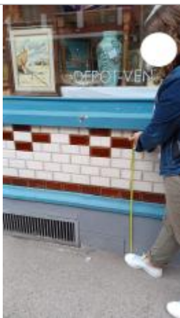
Laisse de crue à 85 cm/sol.
