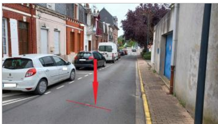
Sol de la chaussée de la Rue Ponceau, au niveau du numéro 18
