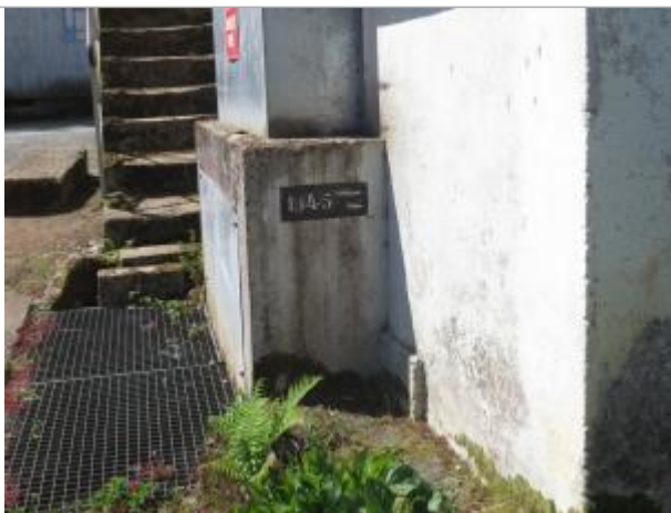
Laisses de crue datant de 1945 - Ecluse du Roch
