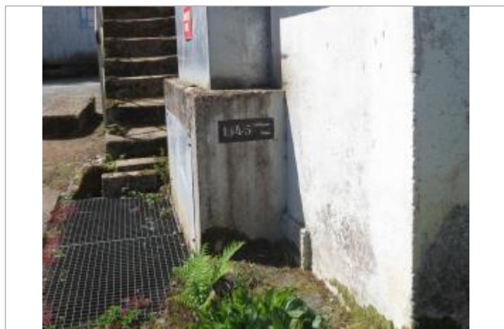
Laisses de crue datant de 1945 - Ecluse du Roch
