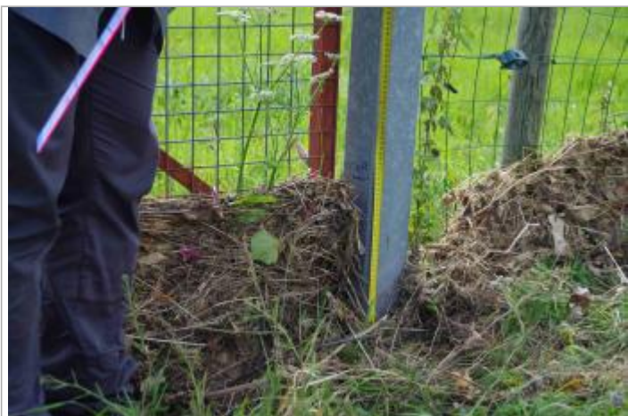
Prise de la mesure au niveau de l'angle du poteau gauche du portail (Source : DDT 61)
