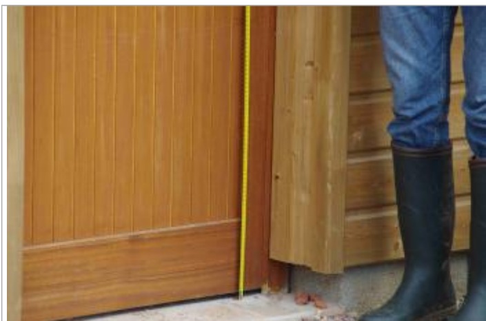
Laisse temporaire laissée sur la porte en bois et marquée au crayon (Source : DDT 61)
