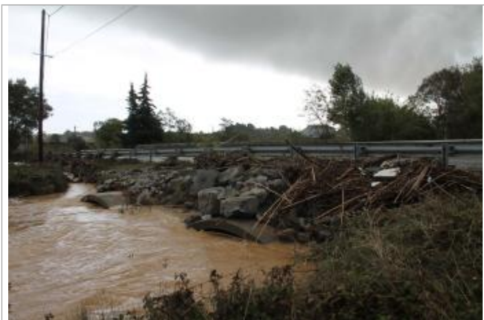
Embâcles côté amont du pont (post-crue)
