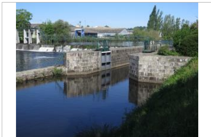
Echelle aval disparue de l'écluse de Lestitut à Pontivy
