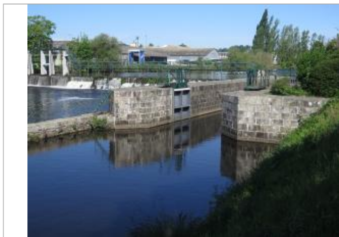
Echelle aval disparue de l'écluse de Lestitut à Pontivy
