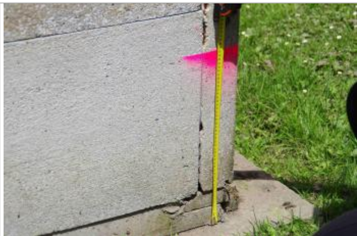
marque de peinture rose sur le mur extérieur du garage à 47.5 cm/sol
