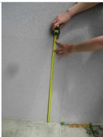
Prise de mesure à partir du seuil en béton proche de la porte d'entrée de la maison collective (source : DDT 61)
