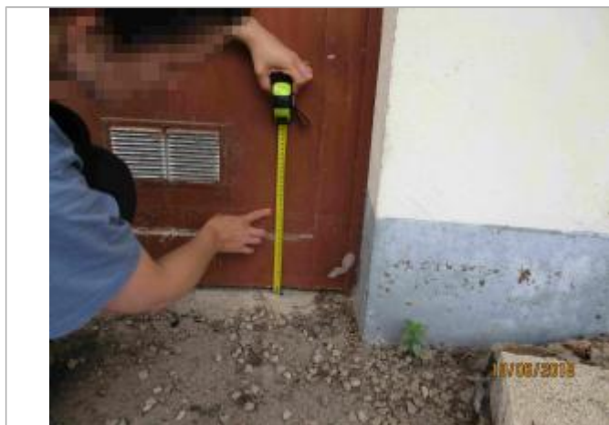
Mesure de la marque au niveau de la porte de garage à 25 cm/sol (source : DDT 61)
