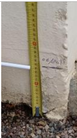
Laisse de crue à 14,5 cm/sol.
