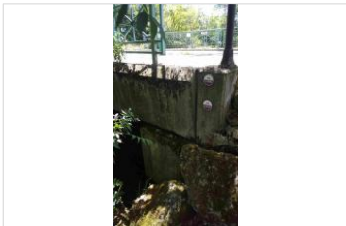
Repère crue 1994, pont route de pompierre
