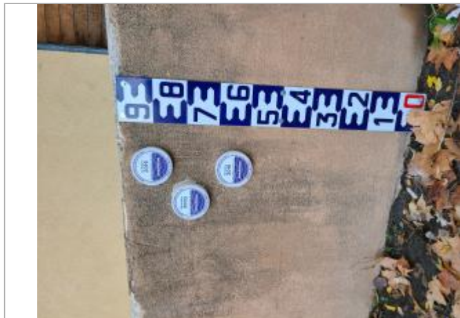
Repères de crue au point bas du parking
