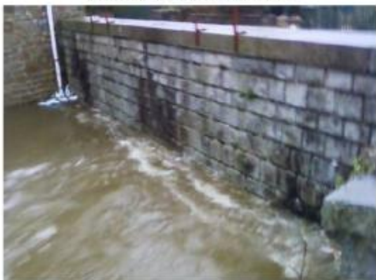
Laisse de crue sur le haut de la première rangée de pierres du garde corps en partant du bas.
