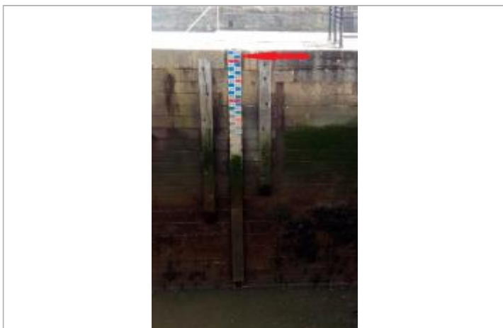
Echelle marégraphe aval de l'écluse du port de Morlaix
