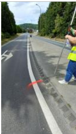
Laisse de crue sur la route.
